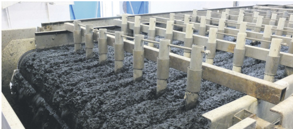
Obecnie osady pościekowe w oczyszczalni w Henrykowie zawierają aż 80 % wody
