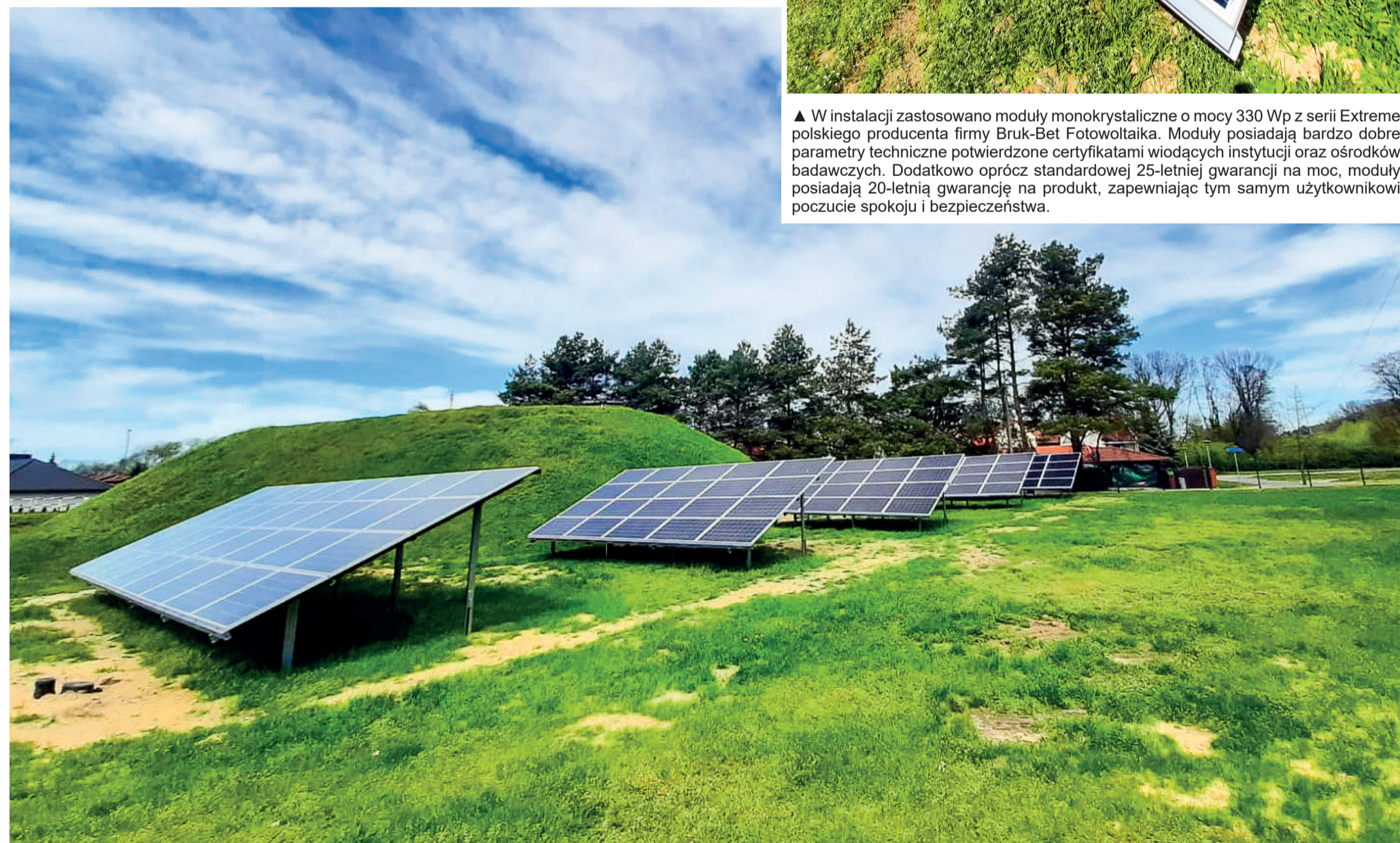
▲ Widok całej instalacji PV o mocy 39,68 kWp składającej się ze 120 szt. modułów zamontowanych na dedykowanej konstrukcji gruntowej z ułożeniem modułów poziomo na pięciu stolach montażowych.
