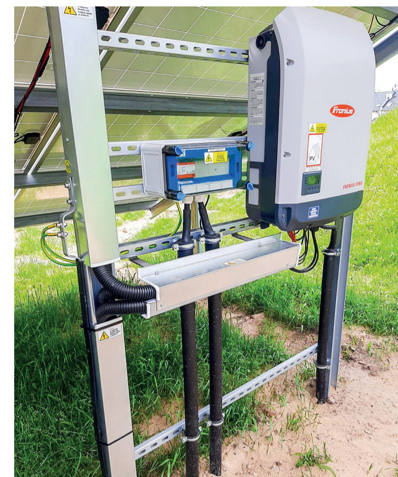
▲ Sercem instalacji są falowniki sprawdzonego producenta firmy Fronius, które wraz z licznikiem SmartMeter, dają pełen podgląd on-line pracy instalacji fotowoltaicznej wraz z możliwością sterowania różnymi parametrami.
